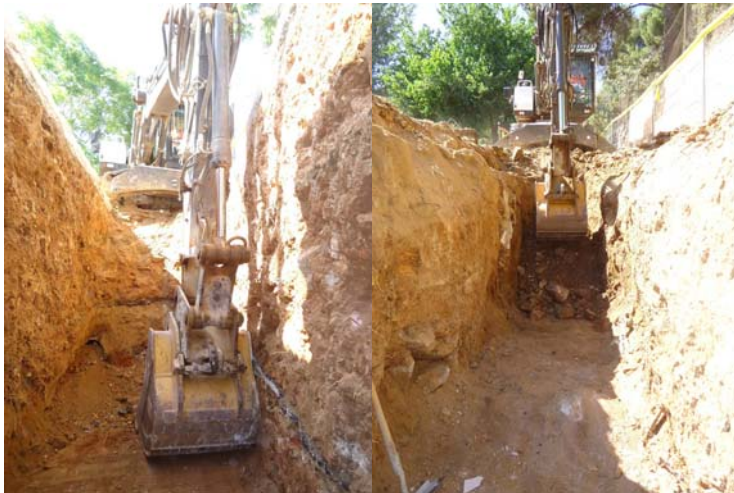
A l'esquerra vista de la rasa des del sud durant el procés d'excavació, on es pot veure els rebliments i els serveis contemporanis. A la dreta, detall de l'aflorament de la roca.
